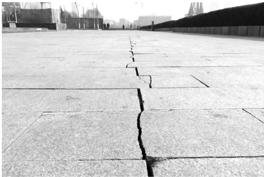
在临沂人民广场西侧,一条近百米的裂缝非常显眼。
