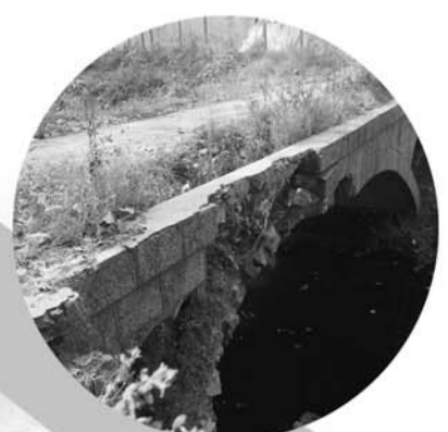
原来的老桥面没有护栏,局部已经塌陷。
