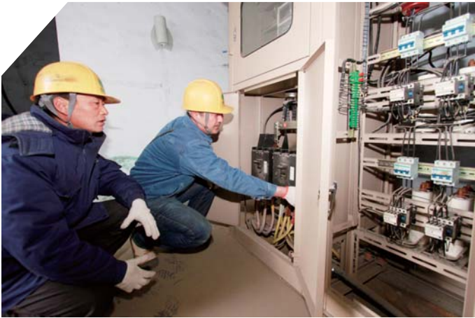
每隔一个小时，姜开元都要到每个村里的配电室检查一遍。
