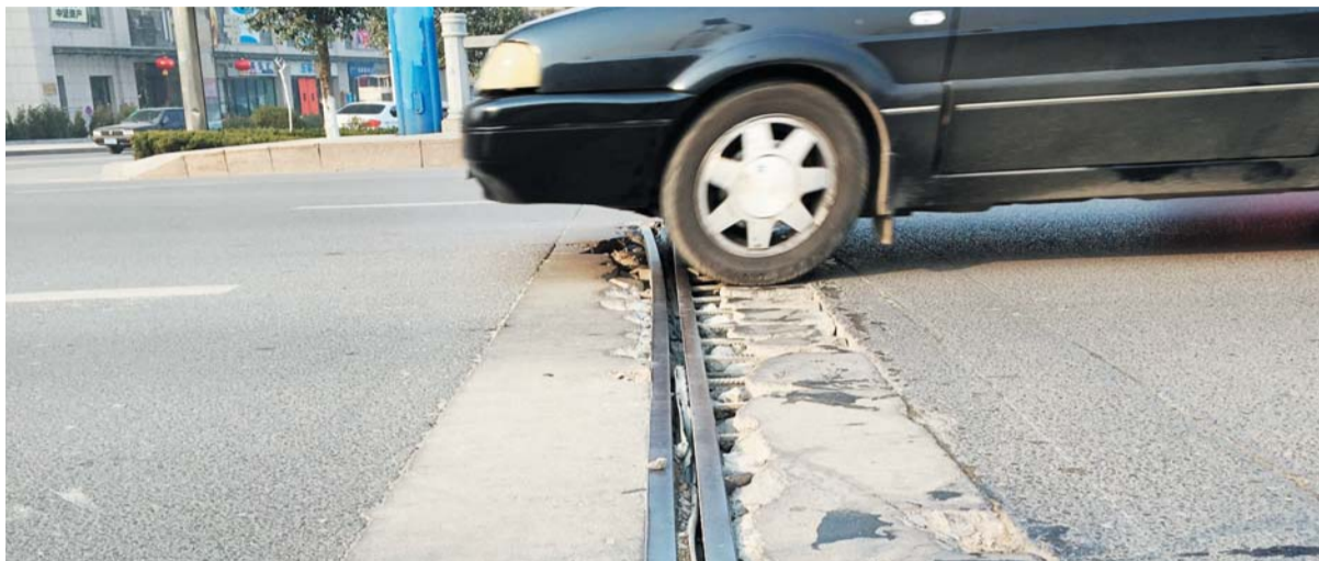
水田桥上破损的伸缩缝。
