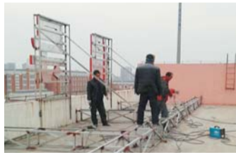
查处楼顶广告安装现场。
