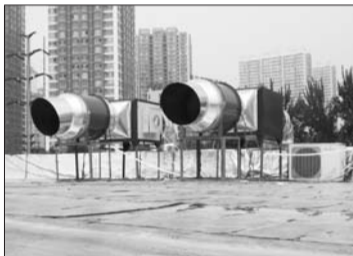
安装餐饮油烟净化设备的排烟管道。
