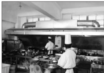
市区一酒店厨房油烟净化设备的收集系统。
