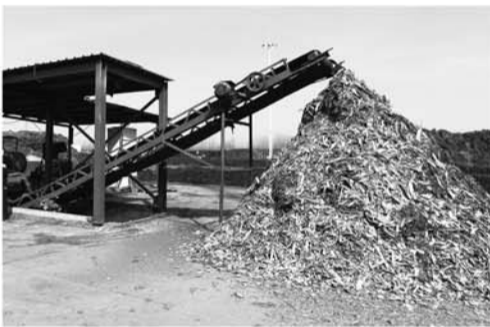
▲国能临沂生物发电有限公司料场内加工设备。
