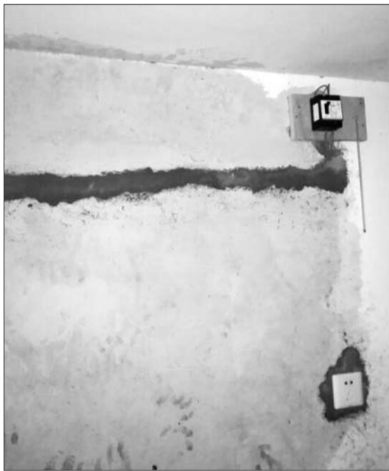
储藏室的墙面都湿透了。
