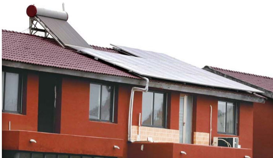
郯城一住户安装了家庭分布式光伏电站。
