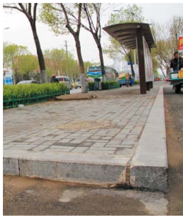
该处公交车站的路沿石高出路面10多厘米。
