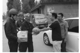
日前,兰陵县省驻村“第一书记”到唐庄村低压集抄表后线改造现场,为头顶烈日奋战在施工现场的供电公司施工人员送去西瓜等物品,感谢他们为线路改造付出的辛勤努力。左肖 辛涛 摄
