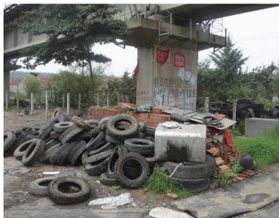
经济技术开发区胶新线与梅开路交会处第31、32、33桥底废旧轮胎、生活垃圾堆在桥墩周围。
