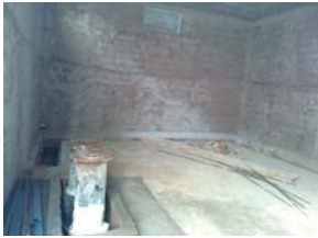
小区换热站内空荡荡的，未见任何机器设备。
